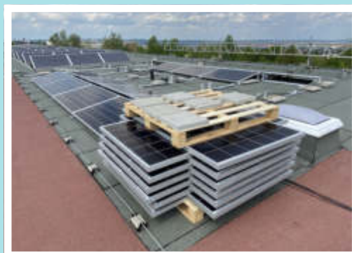
Mit Hilfe eines Krans sind die Solarmodule sicher auf dem Dach angekommen. Nun müssen sie nur noch verbaut werden.
